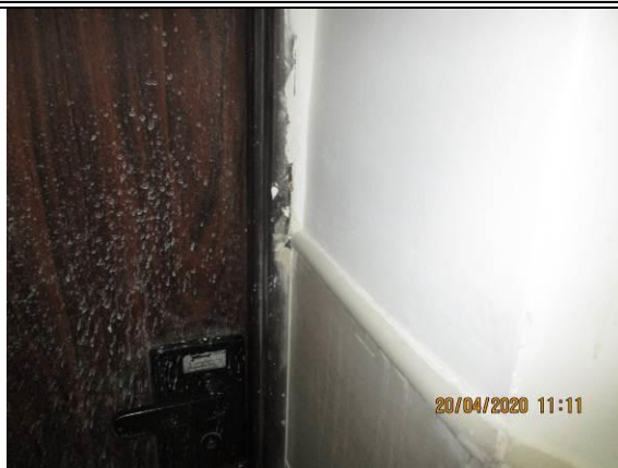
3. גימור לקוי לחלוטין
