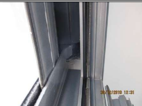
39. לא הורכב מחסום רוח הפנימי
