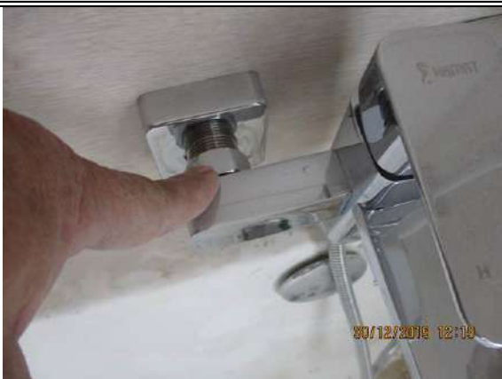
10. הרכבת הברז לקויה
