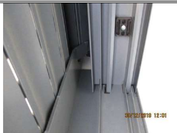
23. לא הורכב מחסום רוח הפנימי
