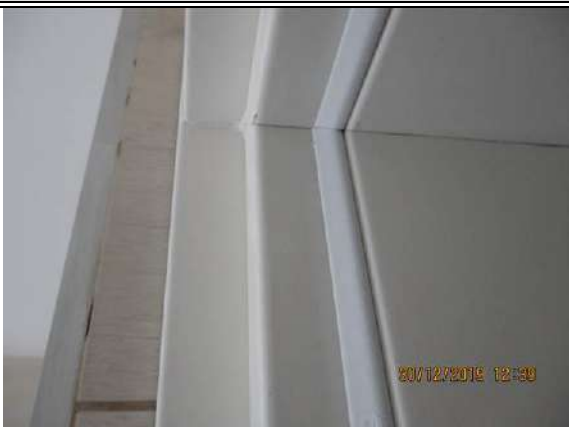
12. הרכבת הלבשות לקויה
